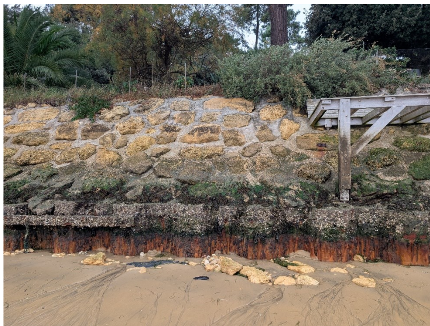
Figure 1-27 Exemple d'ouvrage longitudinal (l'Herbe) où l'abaissement du niveau de plage exposant les palplanches assurant la stabilité de l'ouvrage.
