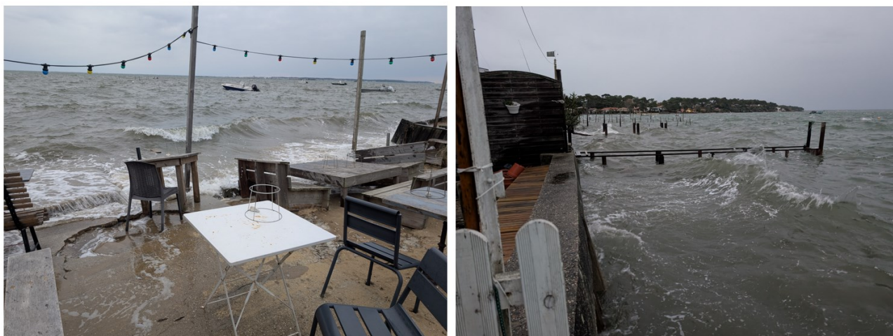
Figure 1-17 Exemple (2) d'attaque par les vagues et de surverse ponctuelle au droit d'un tronçon dégradé. Ces sollicitations répétées fragilisent l'ouvrage et peuvent réduire sa capacité à contenir l'érosion et la submersion.
